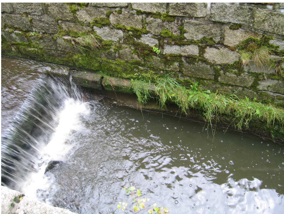
Fot 2. erozji denna występująca poniżej płyty wypadu stopnia (wybój h=1,4\text{ m} ), odsonięty fundament muru lewego
