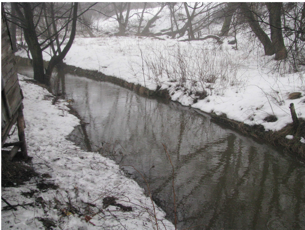
Fot. 5 - odc. II - uszkodzone ubezpieczenie brzegu lewego
