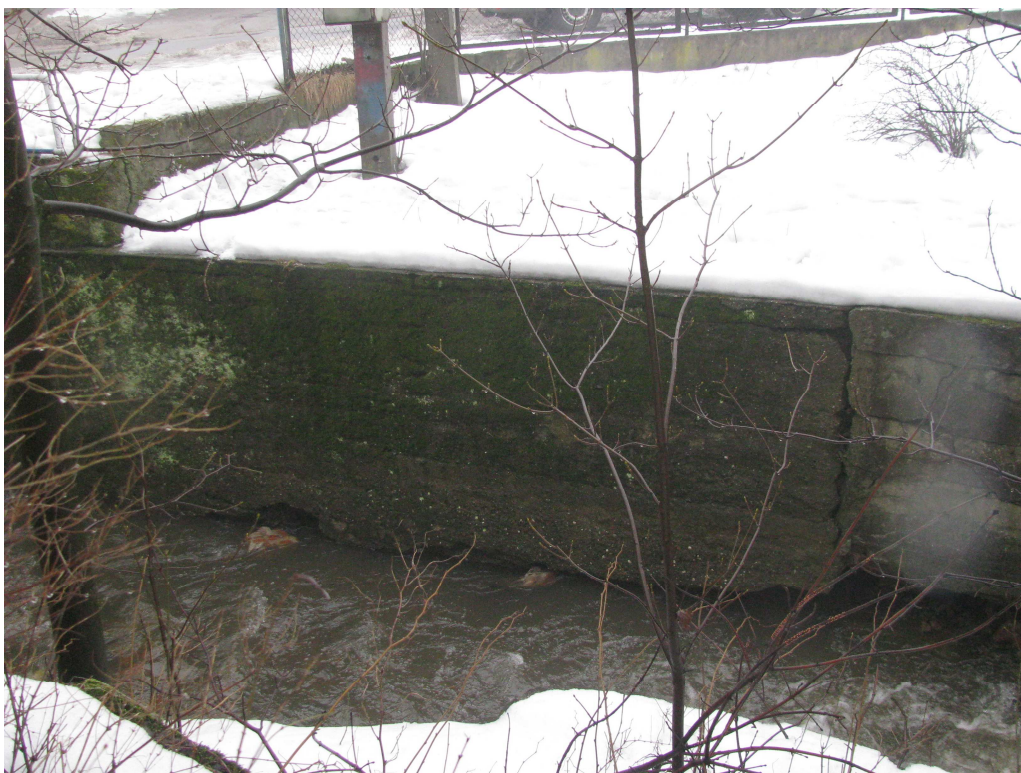
Fot. 4 - brzeg prawy – widoczne ubytki w strefie fundamentowej muru stanowiące zagrożenie dla stabilności muru i słupa energetycznego
