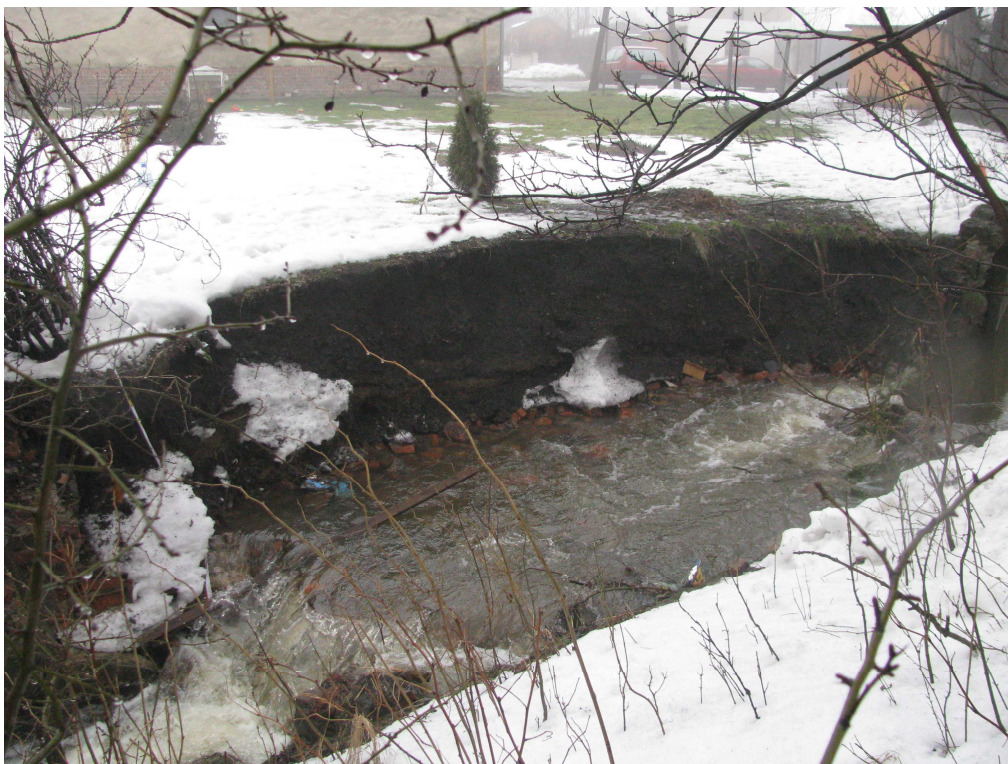
Fot. 3. brzeg prawy – wyrwa brzegowa wynikiem zawalenia się muru oporowego
