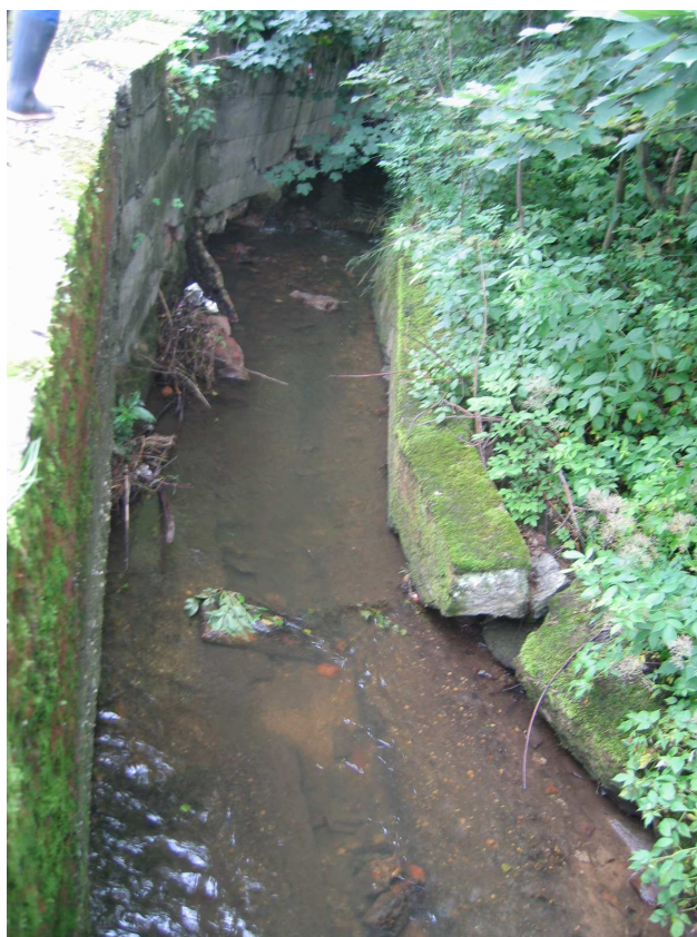
Fot 6 – odc. II – widoczne uszkodzenia ubezpieczeń brzegowych (b. prawy - mur, b. lewy - opaska betonowa )
