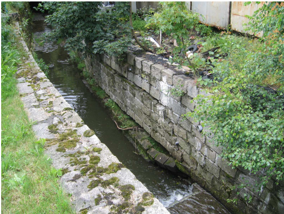
Fot 1. Widoczne pęknięcia i rozwarstwienie się prawobrzeżnego muru oporowego, spowodowane podmyciem fundamentu
