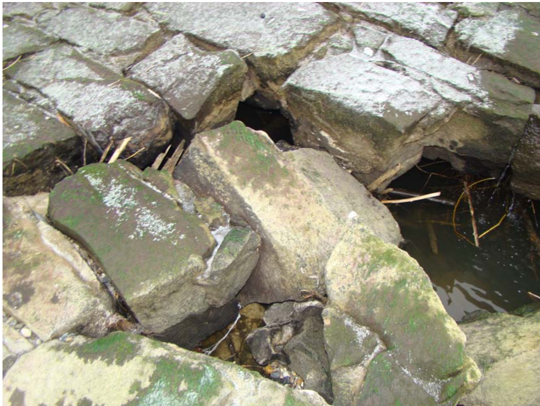
15. Mniejsze wyrwy i ubytki w poszurze jazu.
