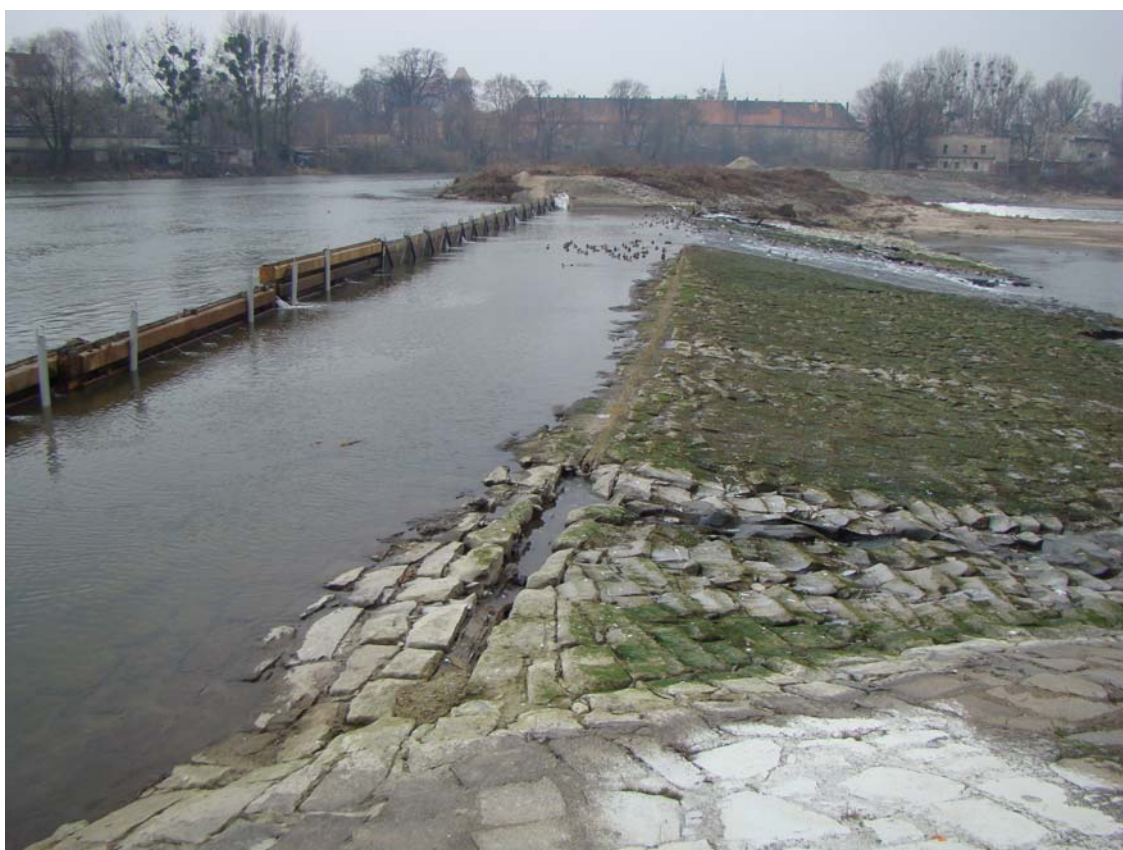
4. Widok jazu z prawego przyczółka. Widoczny częściowy brak oczepu.
