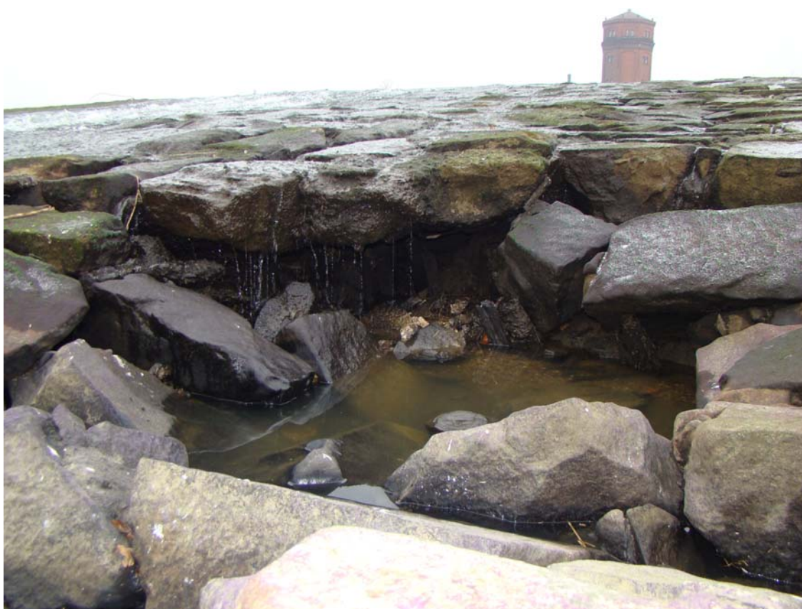
11. Mniejsze wyrwy i ubytki w poszurze jazu.
