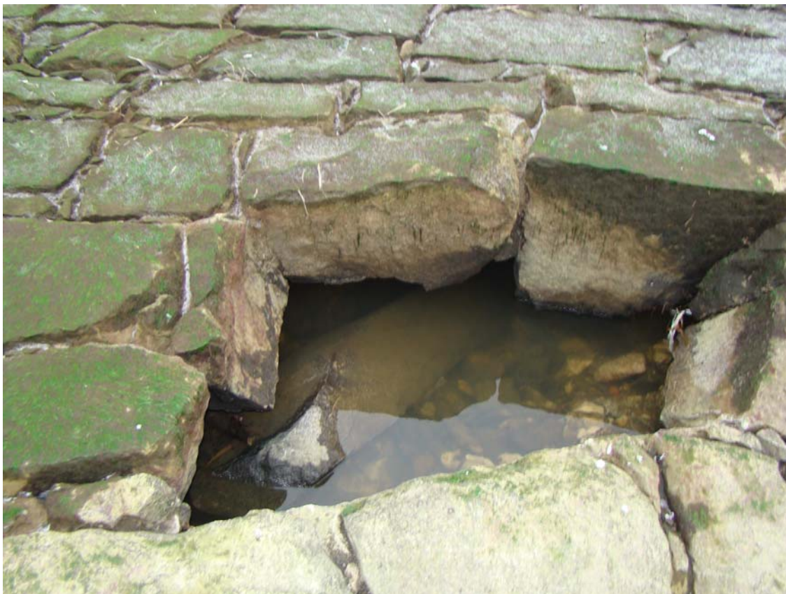
12. Mniejsze wyrwy i ubytki w poszurze jazu.
