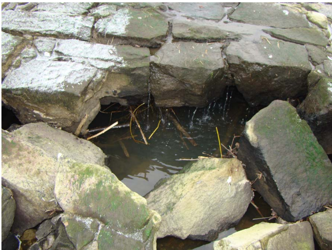
14. Mniejsze wyrwy i ubytki w poszurze jazu.
