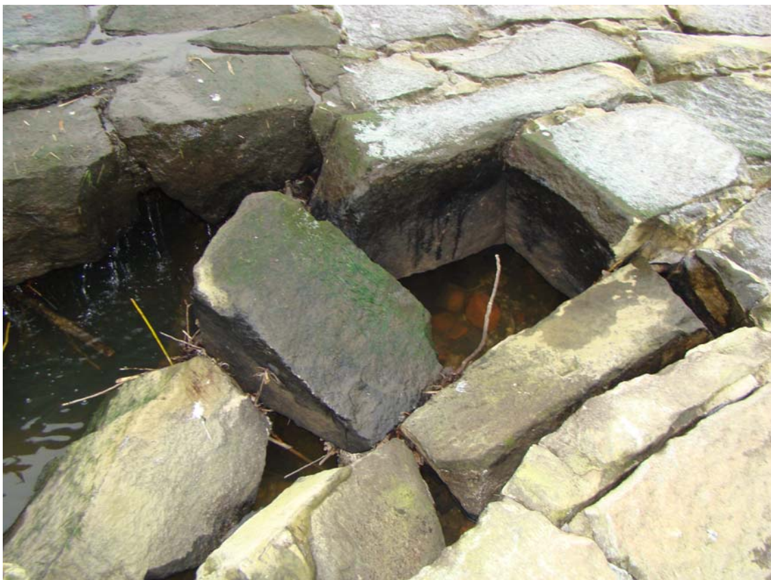
13. Mniejsze wyrwy i ubytki w poszurze jazu.
