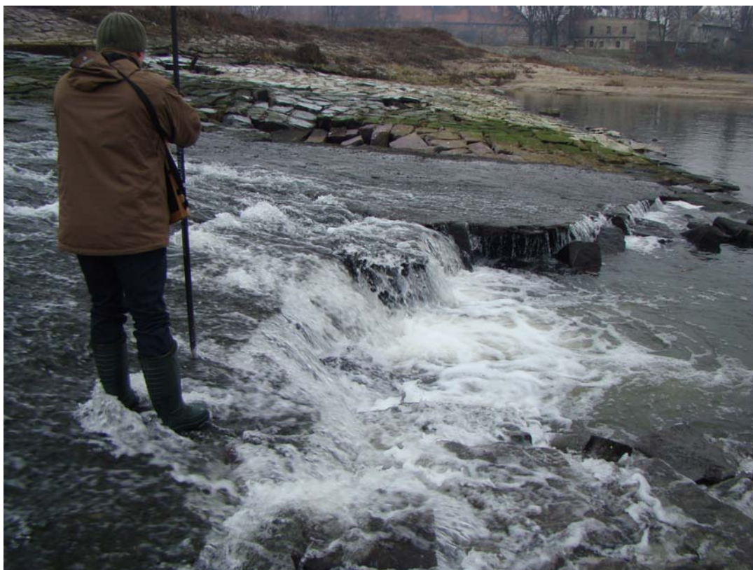
16. Widok na jaz górny ze spadu od strony dolnej wody obrazujący nierówności i zapadliska wskazujące na to, iż cała powierzchnia spadu wymaga remontu.
