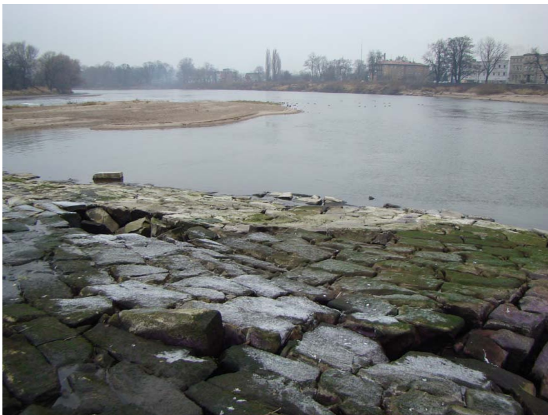
10. Mniejsze wyrwy i ubytki w poszurze jazu.
