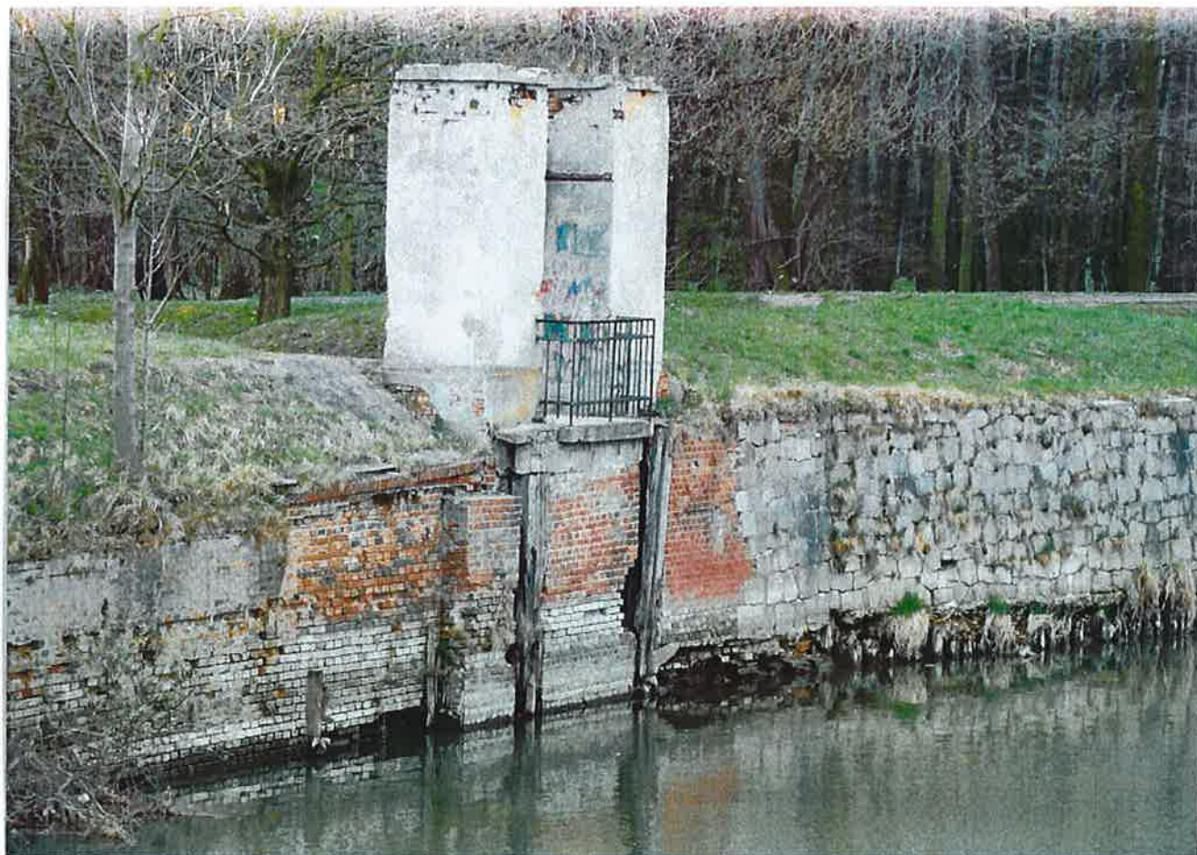
Fot.3. Pylon kładki pieszej prawego nadbrzeża. Widok ogólny stanu zachowania wraz z ceglano-kamiennym murem oporowym.
