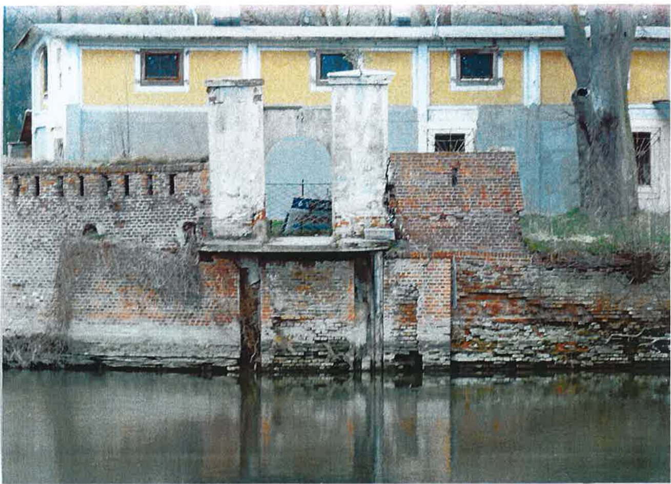
Fot.6. Pylon kładki pieszej lewego nadbrzeża. Widok ogólny stanu zachowania z ceglanym murem oporowym od strony rzeki.
