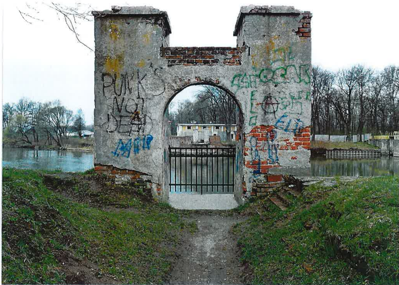
Fot.1. Pylon kładki pieszej prawego nadbrzeża. Widok ogólny stanu zachowania od strony brzegowej. Widoczne rozległe zniszczenia struktury murowanej oraz powierzchni tynków.
