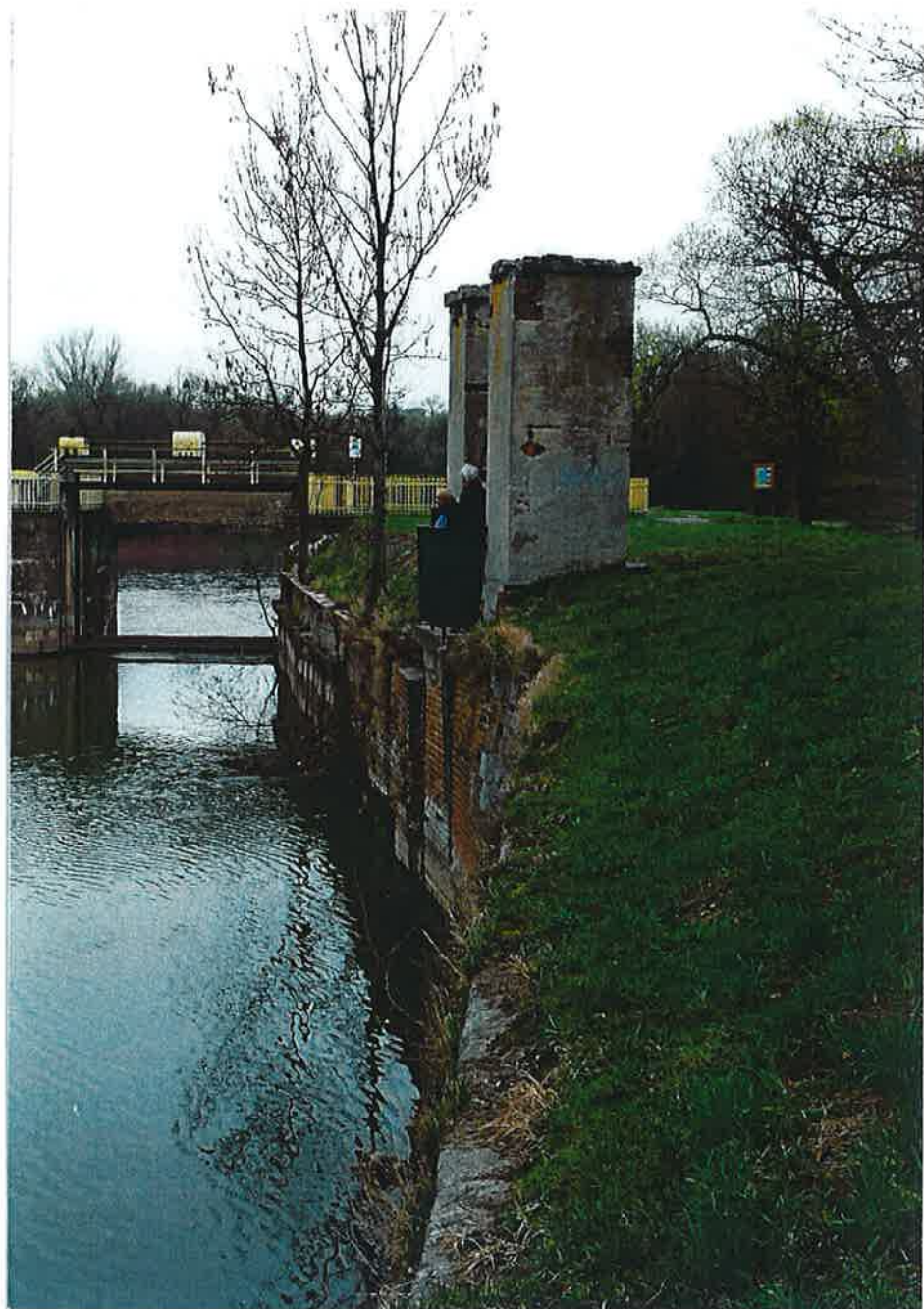
Fot.5. Pylon kładki pieszej prawego nadbrzeża. Widok boczny obiektu z murem oporowym linii brzegowej.
